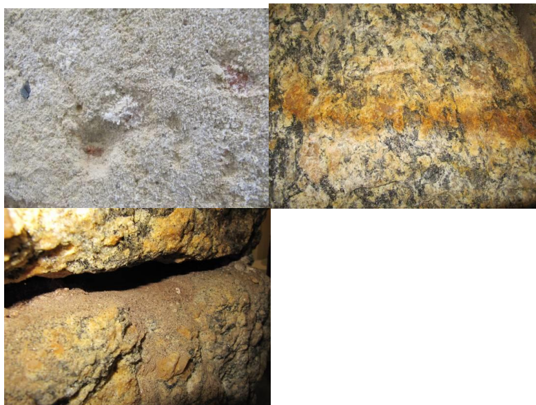
Figura2: Principais danos observados na fachada do Paço Imperial (eflorescência, mudança de cor e crosta negra).
