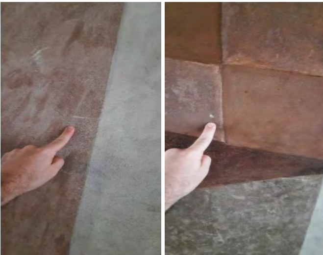
Figura 18. Trincas de obra “Coro”.
