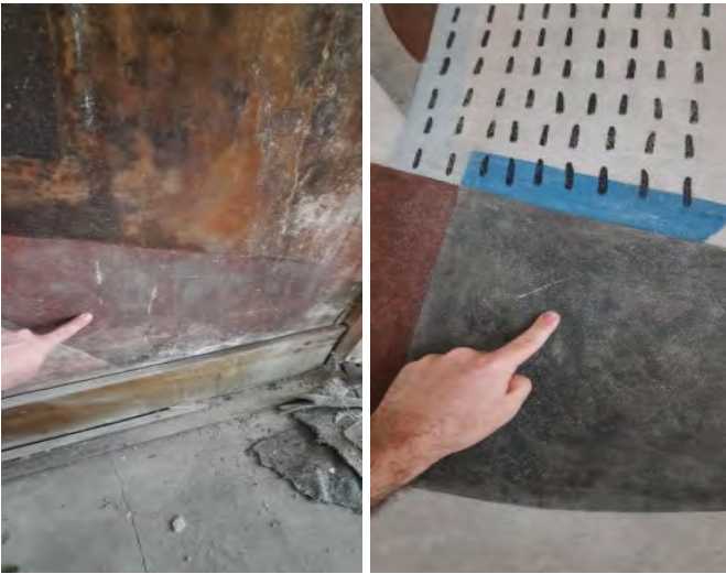
Figura 17. Trincas da obra “Coro”.
