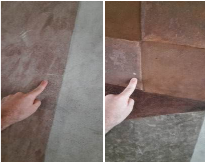
Figura 18. Trincas de obra “Coro”.
