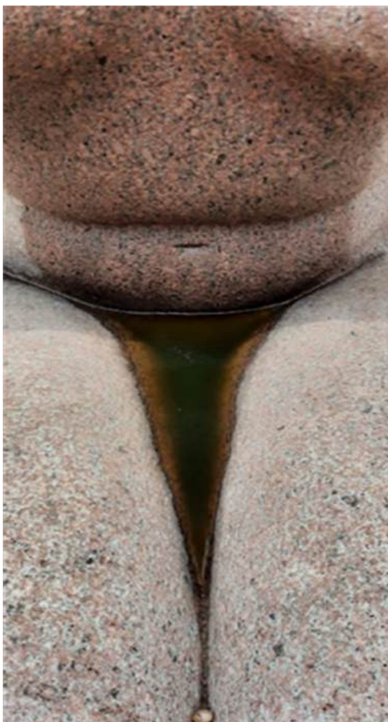
Figura 24. Acúmulo de água, dejetos e colonização biológica.
