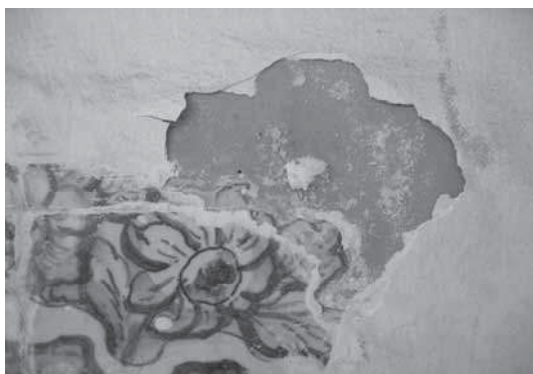
Figura 9** - Eflorescência salina, argamassa de revestimento e silhar; Convento de Santo Antônio – Recife/PE.
