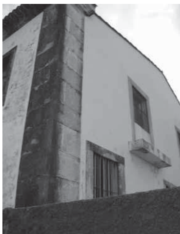
Figura 11 ** - Crosta negra, cunhal; Igreja de Nossa Senhora da Piedade – Jaboatão dos Guararapes/PE.
