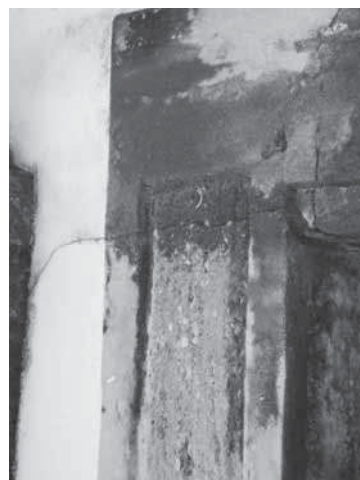
Figura 13** - Fissura e crosta negra, cercadura de portada; Igreja de Nossa Senhora da Piedade – Jaboatão dos Guararapes/PE.
