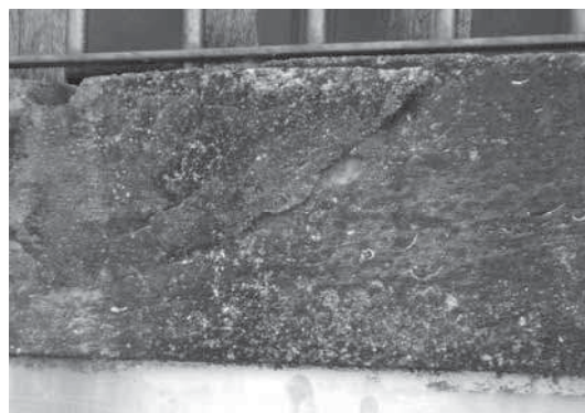
Figura 10** - Esfoliação e pitting , cercadura de janela; Igreja de Nossa Senhora da Piedade – Jaboatão dos Guararapes/PE.
