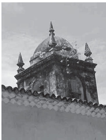
Figura 12* - Presença de vegetação e crosta negra, torre sineira; Igreja de Nossa Senhora das Neves/Conv. Franciscano – Olinda/PE.
