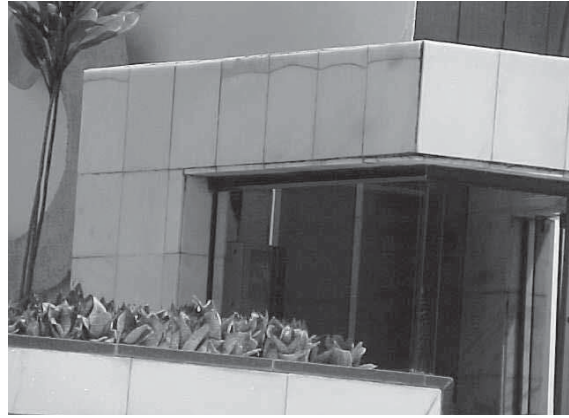
Figura 5: Fissuras (Mármore Branco) Fonte: Silva, S.A.
