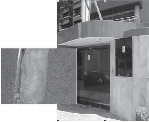
Figura 4: Descolamento de Placas Granito Vermelho Ventura Fonte: Silva, S.A.
