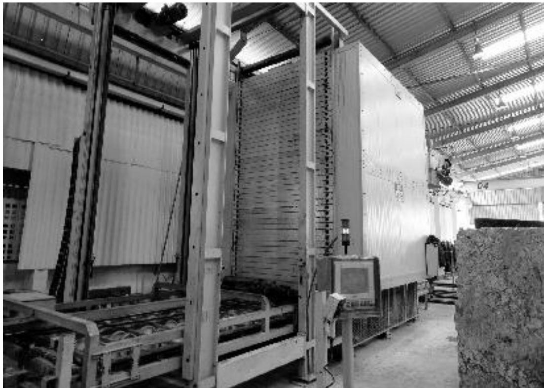
Figura 40 - Detalhe do forno catalisador de cura. Foto: CETEM/MCTI, 2011.
