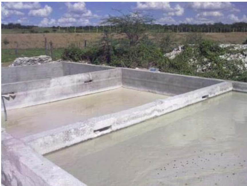
Figura 4 – Detalhes da unidade de tratamento de efluentes em uma serraria de Várzea, já em operação.
