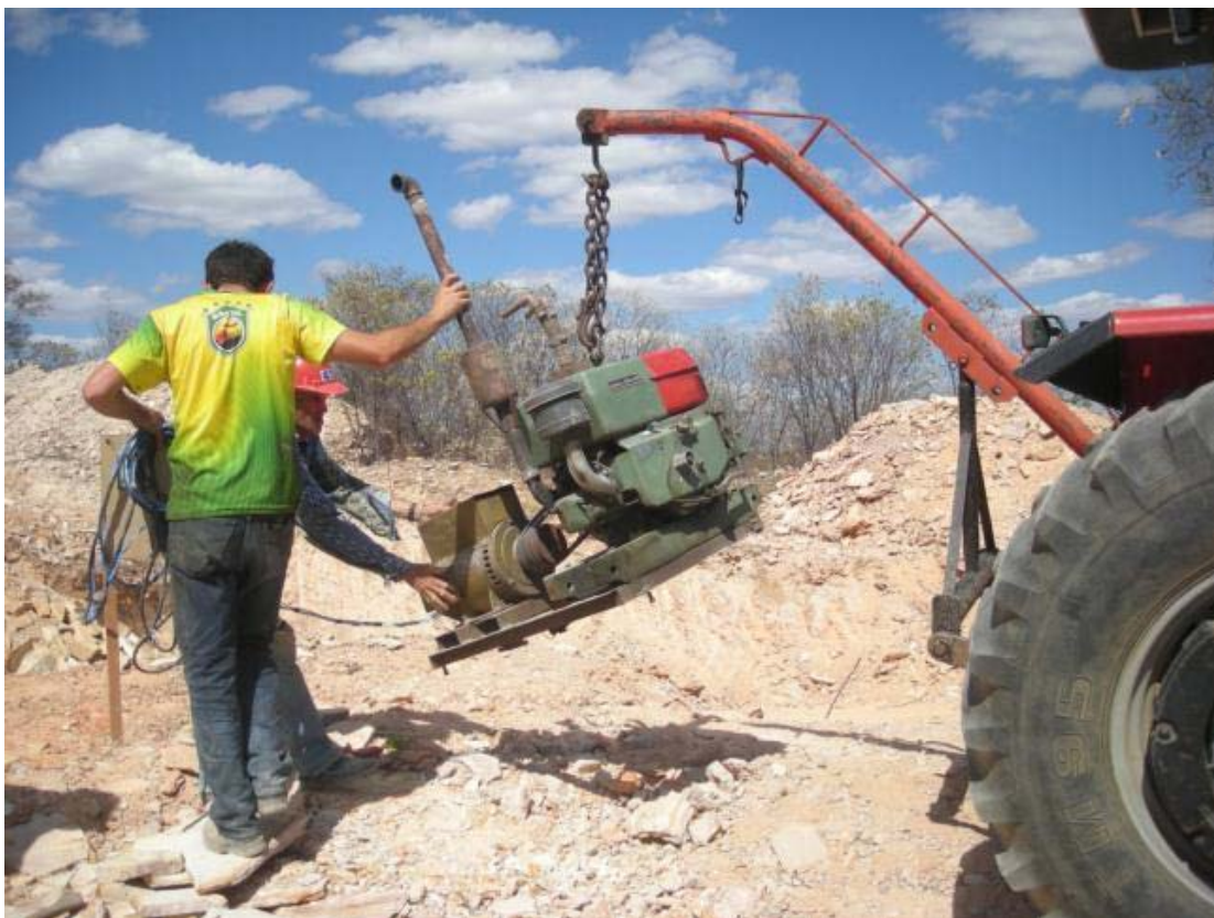
Figura 7 – Gerador utilizado para fornecer energia à máquina. Fonte: Ranieri Pereira
