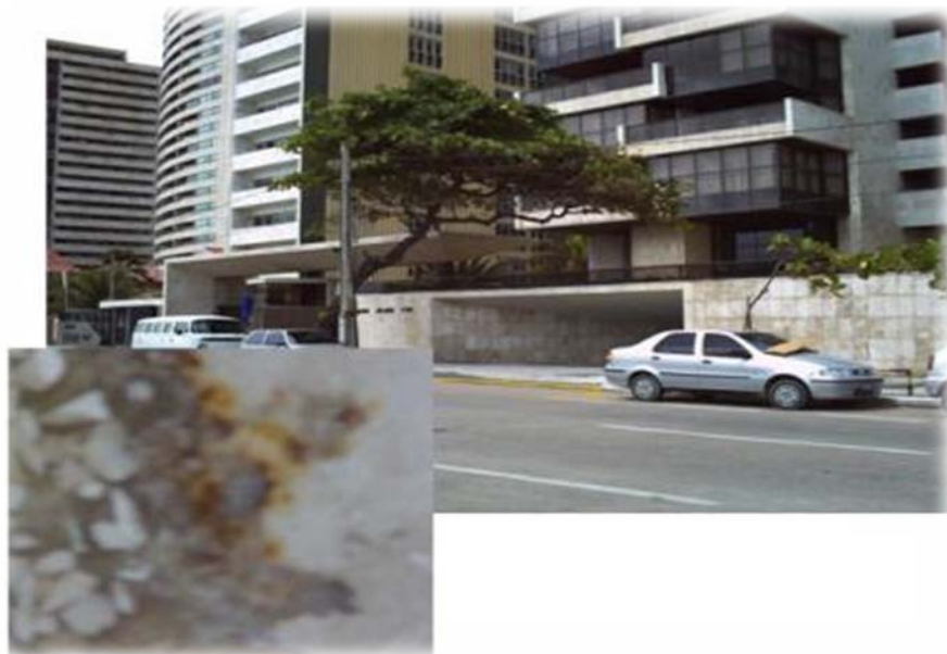
Figura 2 - Aspecto de fachada com revestimento de “Bege Bahia”, com 20 anos de exposição. Notar a segregação secundária (detalhe) resultante da mobilização e reprecipitação de Fe sob influência intempérica.
