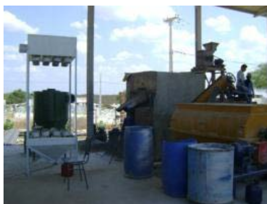
Figura 7 -Mostra, à direita e acima, moinho de martelos, peneiramento no trommel enclausurado, transportador de rosca e um dos misturadores (tom amarelo); à esquerda o início da instalação dos filtros de manga
