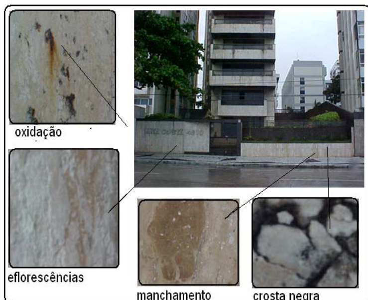
Figura 1 – Ocorrências de patologias em edificação localizada na região litorânea do Recife.
