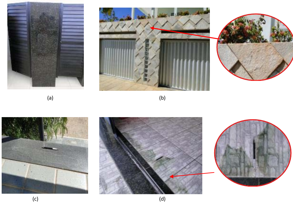
Figura 3 – (a) Divisórias de granito em banheiro; (b) Jardineira em cima do muro revestido com quartzito; (c) Mancha esbranquiçada em soleira de granito; (d) Mancha verde proveniente do granito verde Ubatuba.
