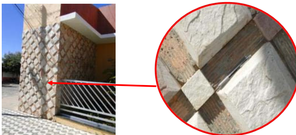
Figura 2 – Descolamento de filetes de 0,20 x 0,05 m em fachada de residência.
