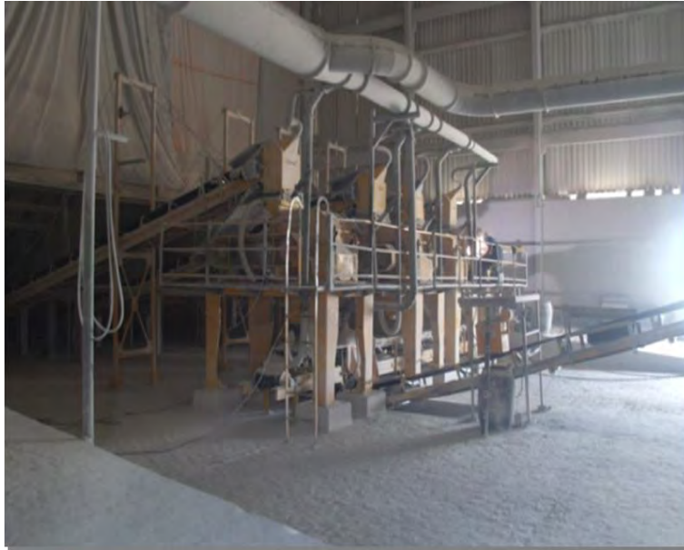
Fig. 7. Bateria de quatro moinhos de martelo
