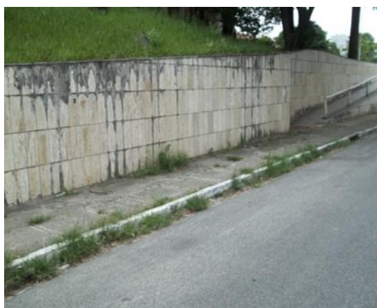
Figura 6 - material alterado e com fungos
