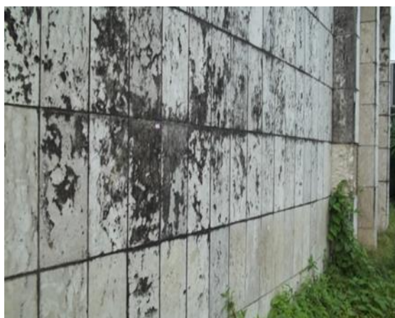
Figura 7 – ataque dos fungos nas paredes
