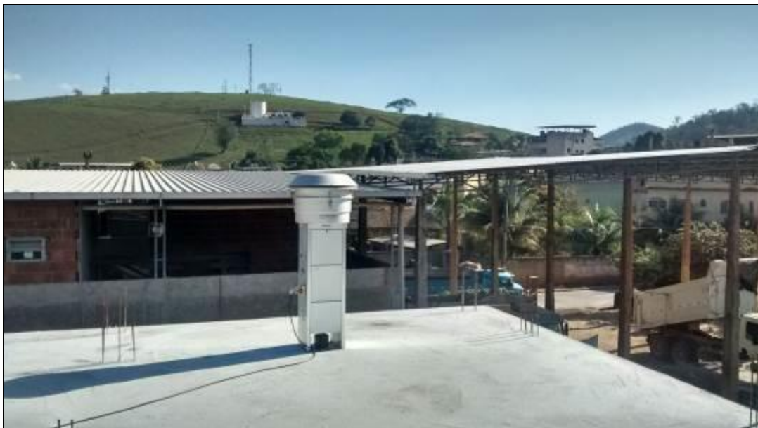
Figura 4 – Amostrador de Grande Volume – AGV/“HiVol” instalado para medição de PM10 no ponto/local na Rua Pedro Vivacqua, 59, Distrito de Itaoca Padra, Cachoeiro de Itapemirim-ES.
