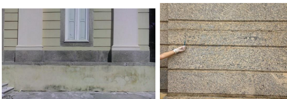
Figura 4.1.1: Alteração cromática das rochas na fachada do Museu
