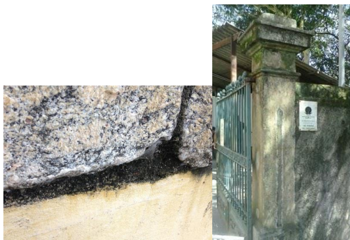
Figura 4.1.3: Colonização biológica na fachada e pilastras. 11
