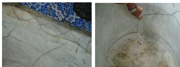
Figura 6 - Fissuras e fraturas encontradas nas banheiras
