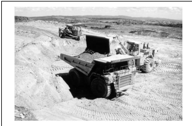
Figura 12 – Sistema carregadeira frontal/caminhão usualmente empregado em pedreiras com trator dando suporte em operações auxiliares.
