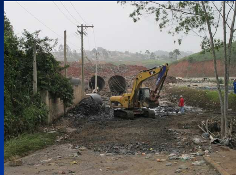
Chorume invadiu quintais após explosão em aterro sanitário de Itaquaquecetuba (Foto: Juliana Cardilli/G1)
