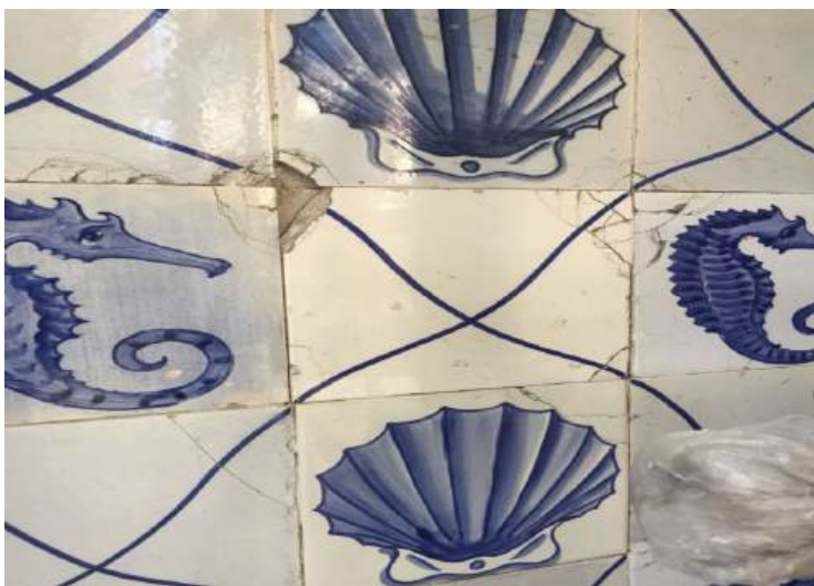
Figura 22: Trinca e fissuras.
