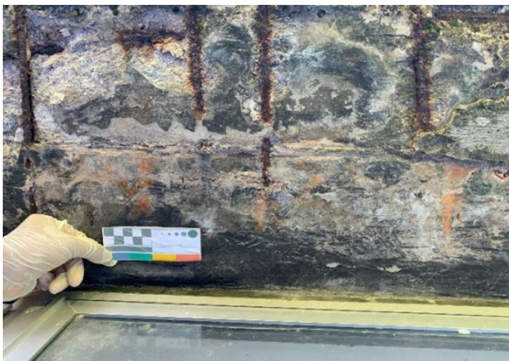
Figura 17. Oxidação visível da armação metálica do concreto.
