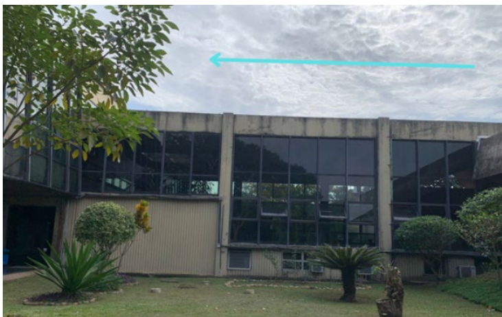
Figura 16. Região da fachada apontada no mapeamento.
