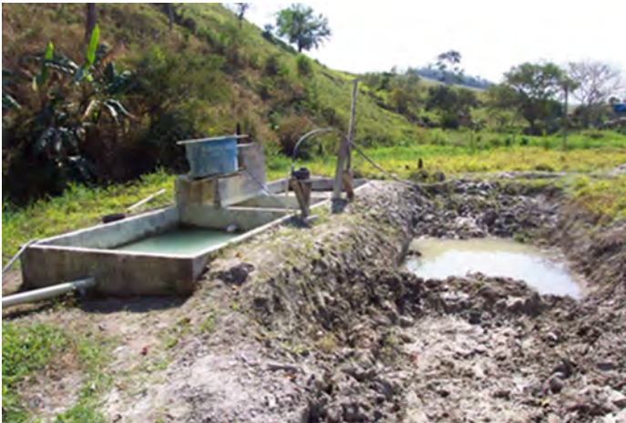
Figura 3: Tanques de decantação para o resíduo fino.
