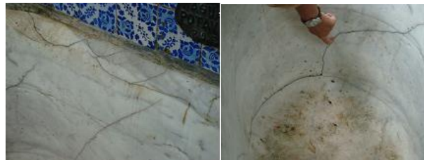
Figura 4.3: Fissuras e fraturas encontradas nas banheiras
