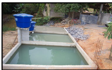
Figura 02: Unidade de Tratamento de Efluentes (UTE)
