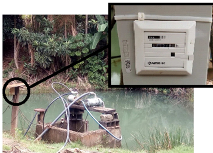
Figura 2: Horímetro instalado na bomba hidráulica.
